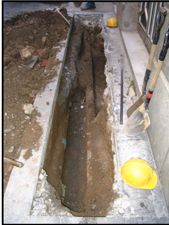
Foto 9. Vista de la rasa en el tercer tram, s'observen a la dreta el servei d'electricitat i a l'esquerra un altre servei de canalització de gas.
