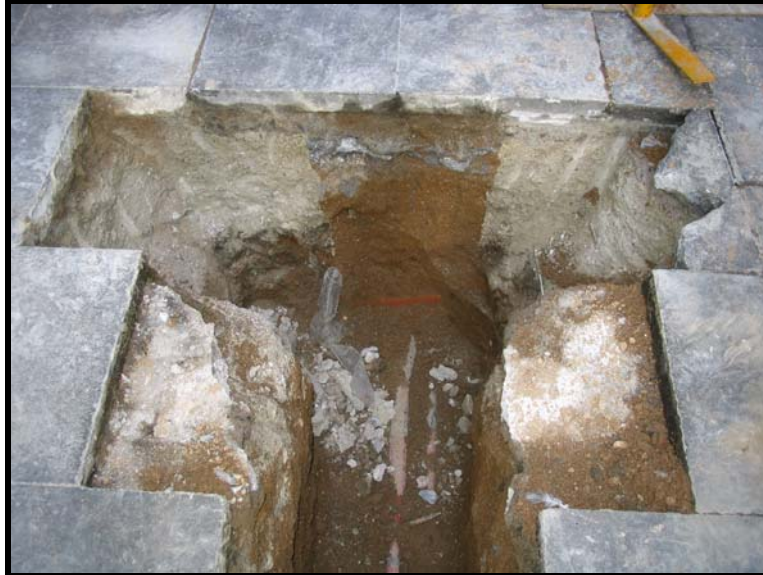
Foto 1. Inicial de la rasa al c/ Sant Bertran. Es pot observar la rasa UE 1003 de l'anterior cablejat per al servei d'electricitat UE 1005, i el seu corresponent farciment de sauló UE 1004 .
