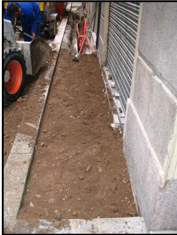
Foto 17. Vista de les obres a l'alçada del nº 26, on s'observa el servei elèctric que travessa tota la rasa i la part ja coberta.
