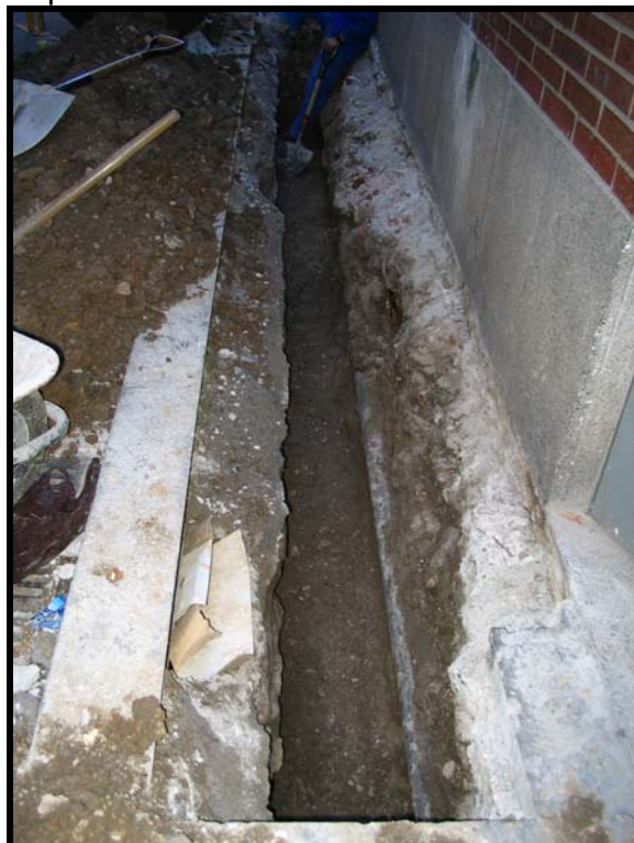
Foto 6. Vista del segon tram de l'inici de la rasa al carrer de Santa Madrona en sentit sud. Es pot observar la dreta la canalització d'electricitat que travessa la rasa.
