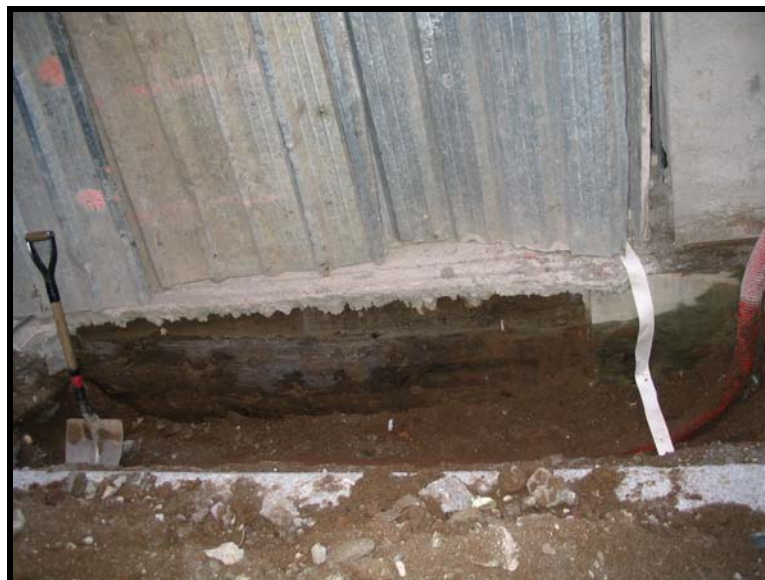
Foto 12. Vista del fonaments del nou habitatge de la finca nº26, on encara són presents els encofrats realitzats amb taulons de fusta.
